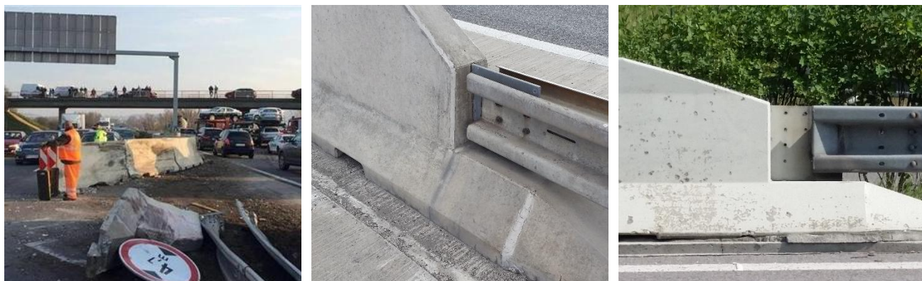
Obr. 3 Bezpečnostný deficit vzájomného spojenia zvodidiel [8]
